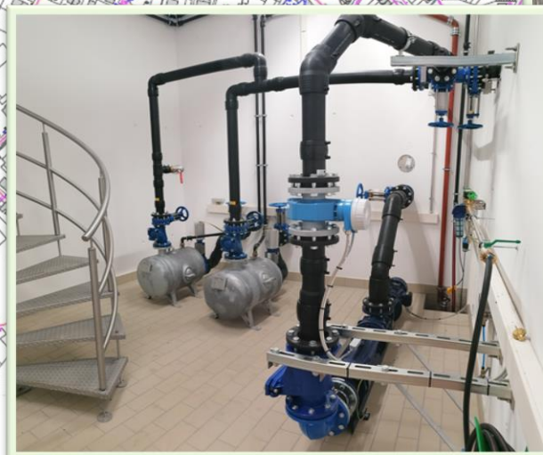
Pneumatik-Pumpstation mit Regenwetterpumpe Weißling
